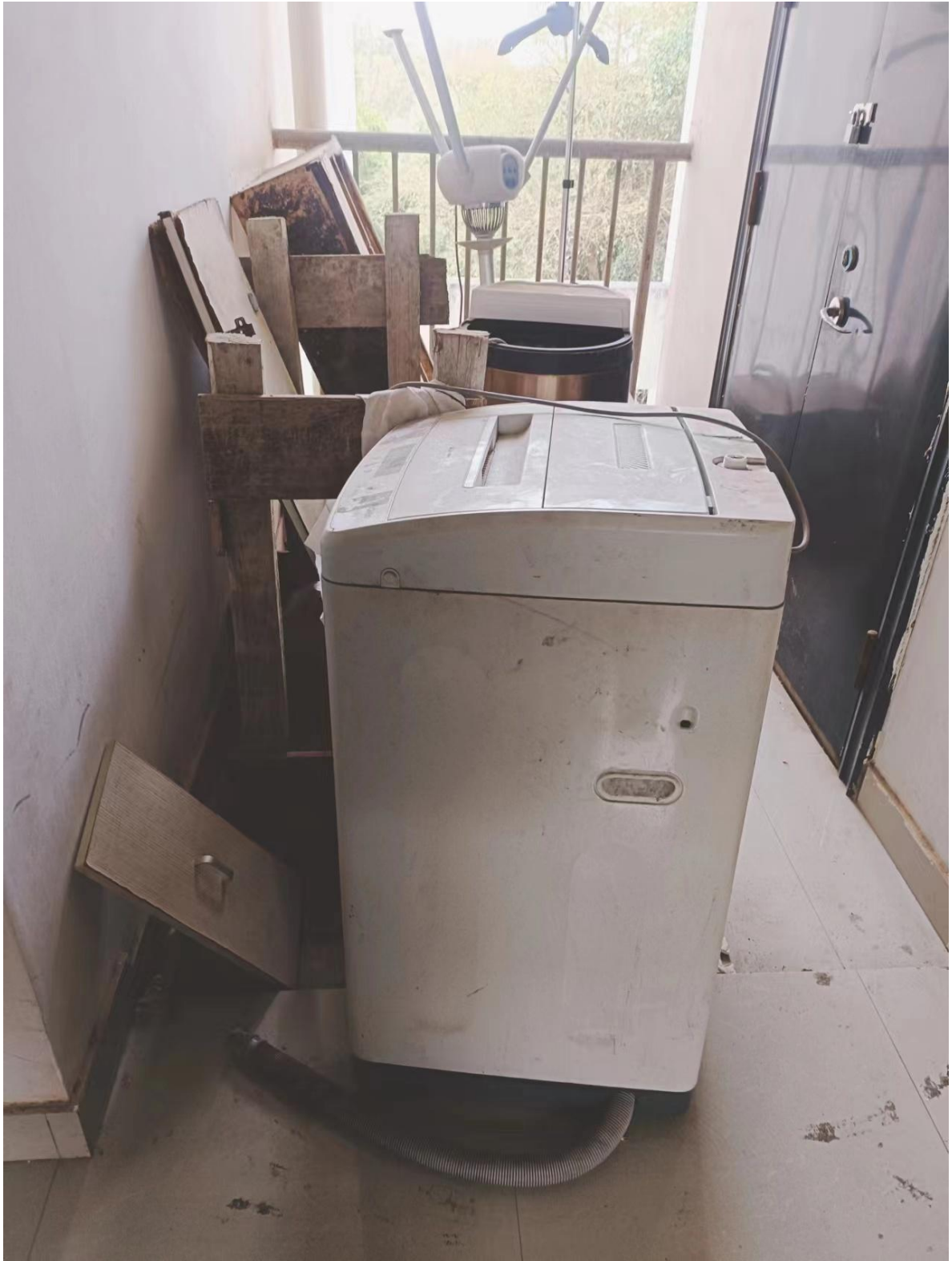
8 栋 4 楼 配 电 房 外
