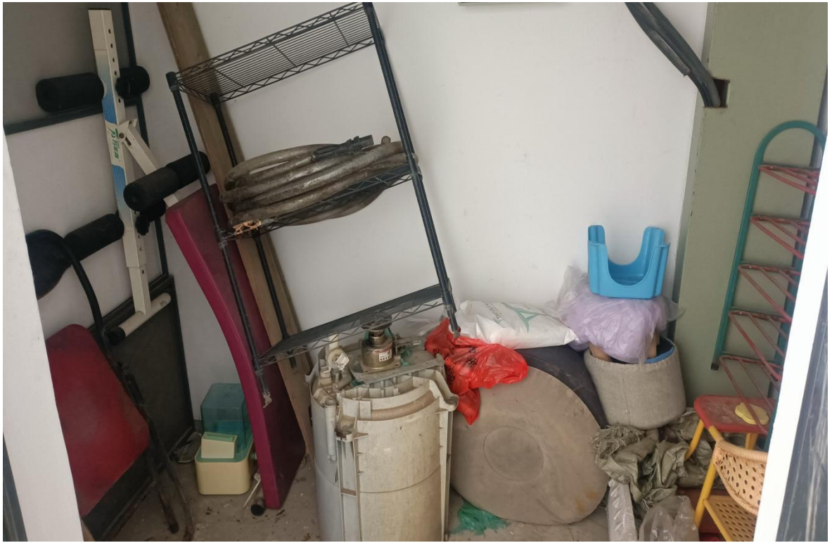
8 栋 5 楼配电房内
