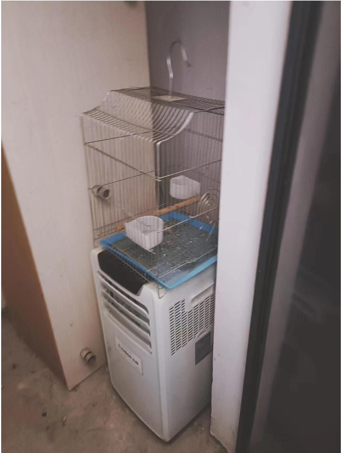
8 栋 4 楼 配 电 房 内
